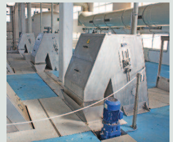
Instalación de filtrado y transporte de residuos en la EDAR de Torreveja
